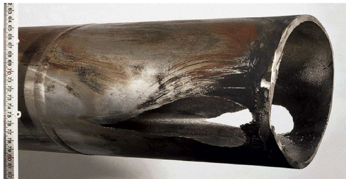
Slika 6. Prikaz erozijske korozije legure Hastelloy C-276 [19]
