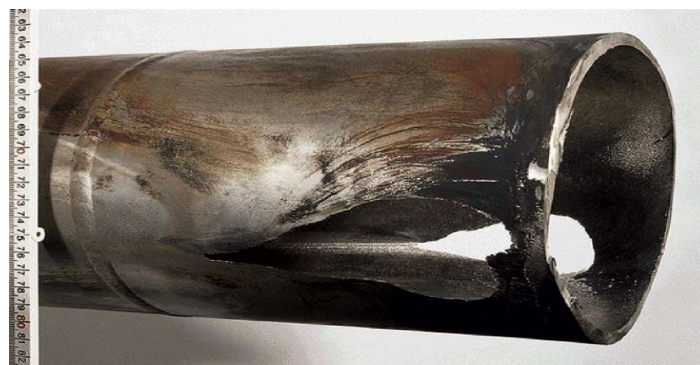
Slika 6. Prikaz erozijske korozije legure Hastelloy C-276 [19]
