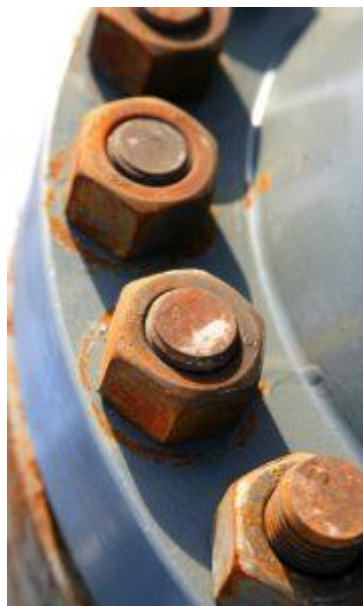
Slika 21. Primjer galvanske korozije na maticama i vijcima [20]
