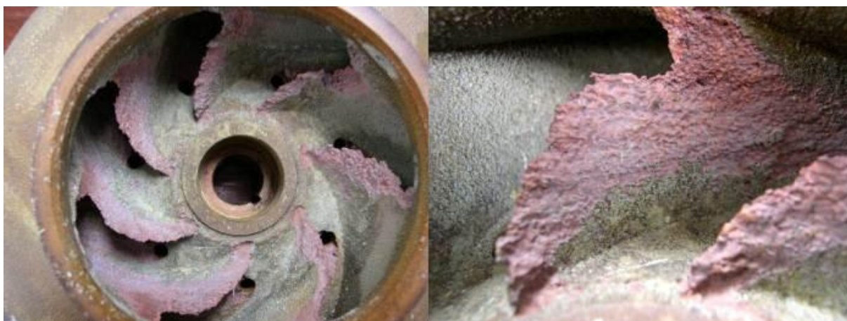
Slika 27. Oštećenja na lopaticama pumpe uzrokovana erozijskom korozijom [33]
