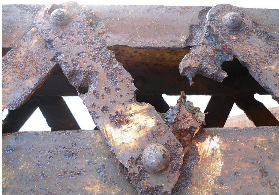
Slika 22. Konstrukcija mosta zahvaćena rupičastom korozijom [29]
