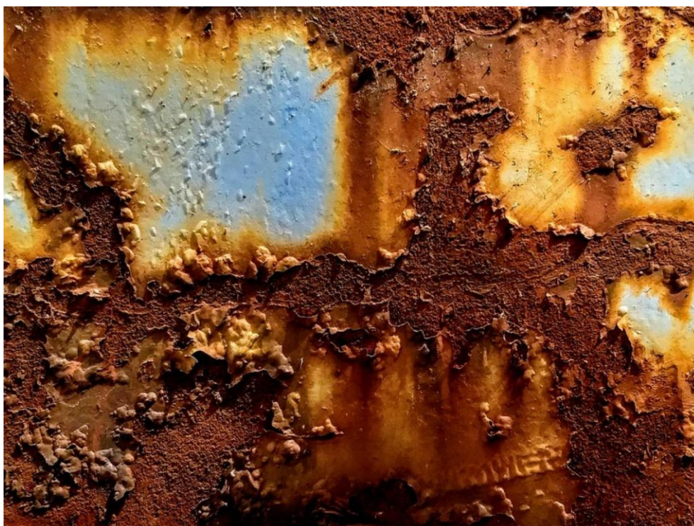
Slika 18. Površina zahvaćena općom korozijom [25]
