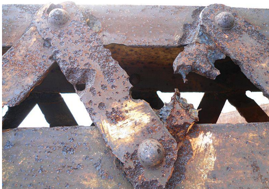
Slika 22. Konstrukcija mosta zahvaćena rupičastom korozijom [29]
