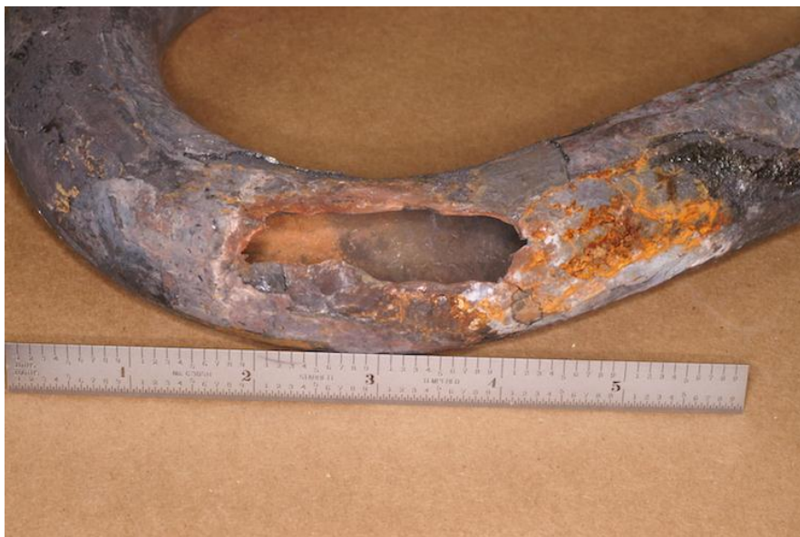
Slika 28. Oštećenje uzrokovano erozijskom korozijom [34]
