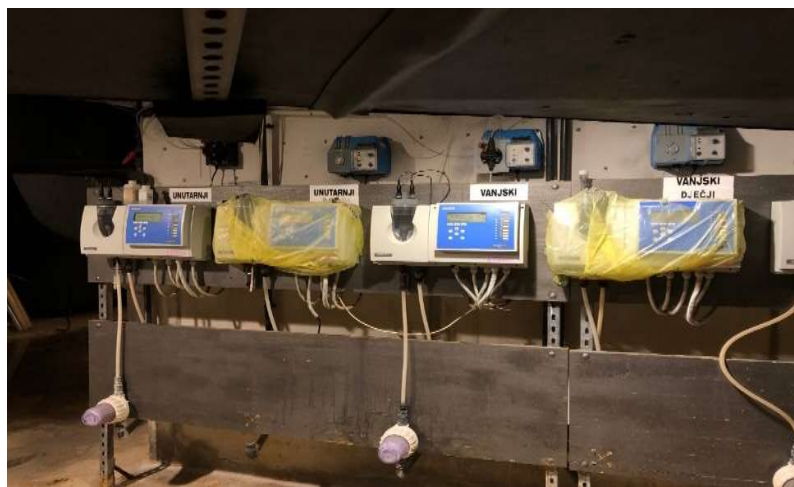
Slika 35. Postrojenje za dodavanje klora u bazensku vodu
