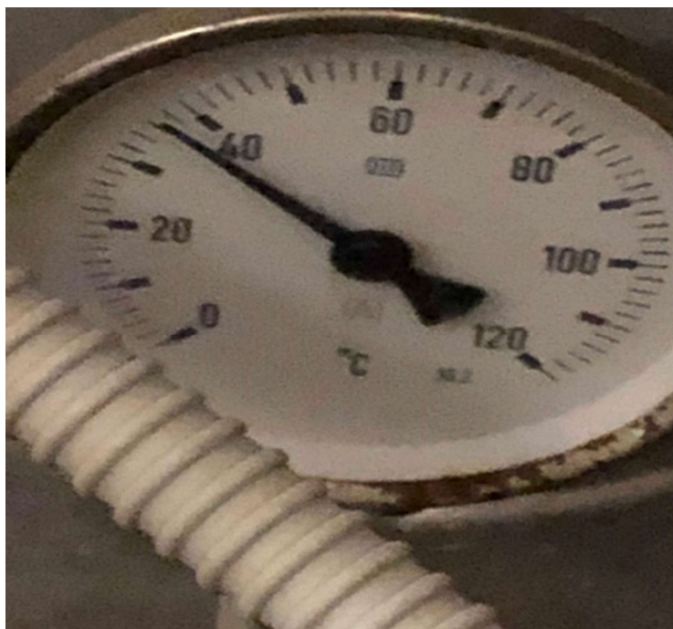
Slika 34. Temperature PTV-a u 2. spremniku (bojleru)
