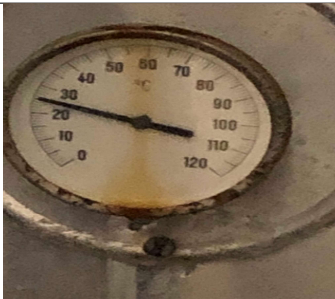
Slika 29 Temperature PTV-a u 1. spremniku (bojleru)
