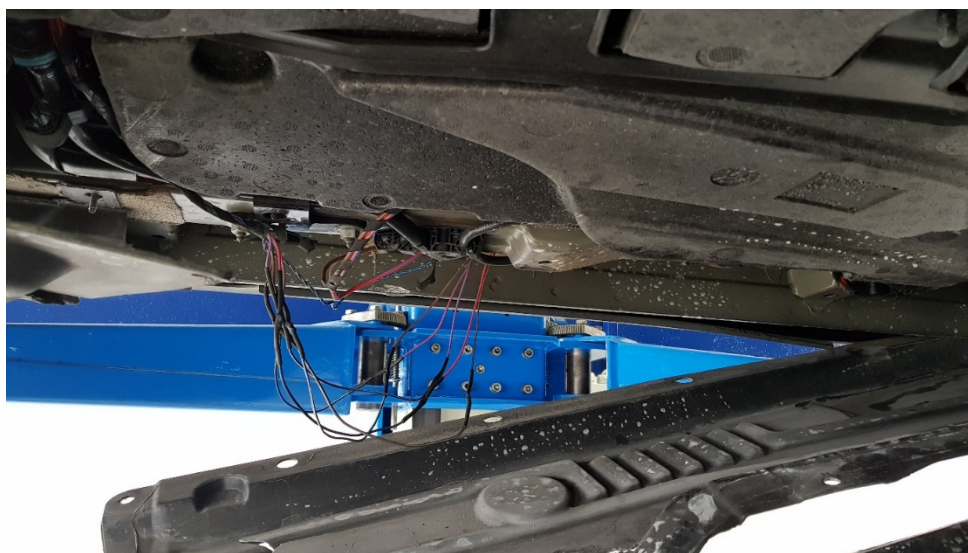
Slika 6.27. Primjer neispravne električne instalacije na NO x senzora
