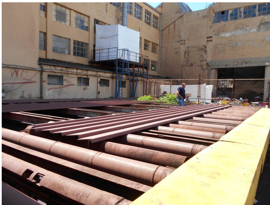
Slika 22. Profili zaštićeni temeljnim radioničkim premazom
