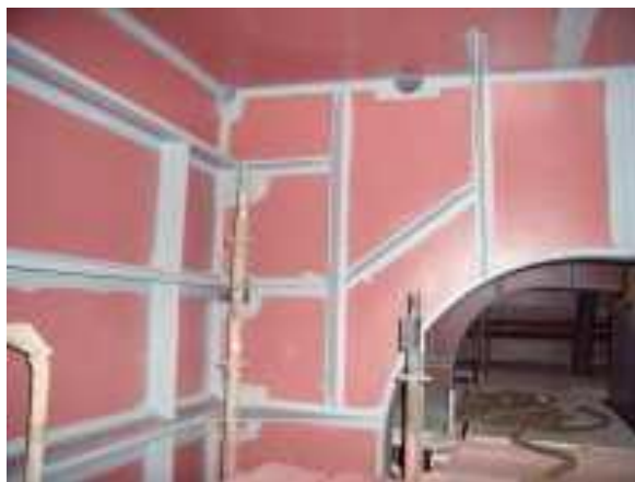
Slika 24. Flekanje kritičnih mjesta na konstrukciji
