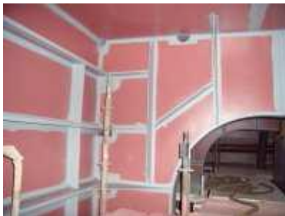
Slika 24. Flekanje kritičnih mjesta na konstrukciji
