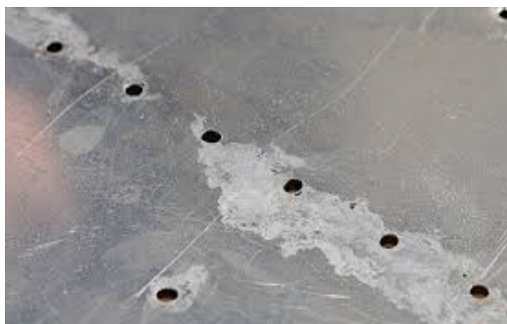
Slika 13: Korozija na mjestu spojeva zakovicama na oplati zrakoplova [25]
