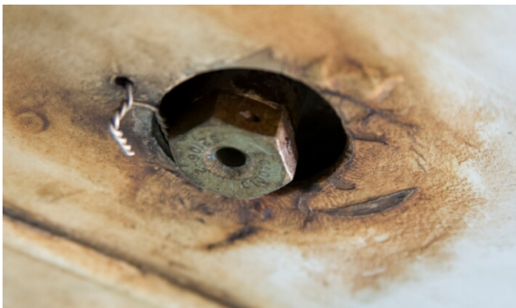
Slika 14: Korodirani aluminijski dio na zrakoplovu [27]
