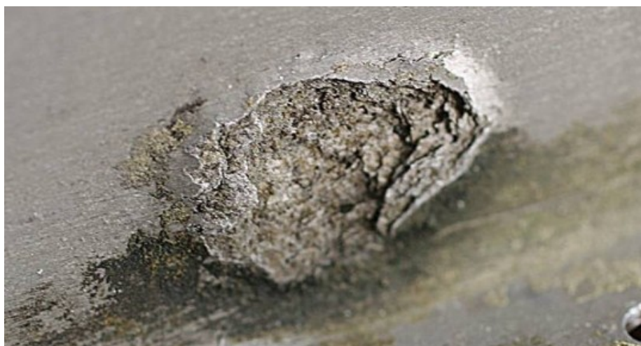
Slika 21: Raspljavanje aluminijske legure uslijed interkristalne korozije [37]
