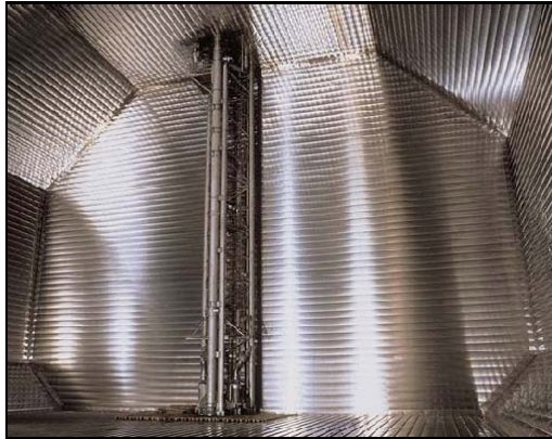
Slika 2.12. Pumpni toranj u LNG tanku [8]
