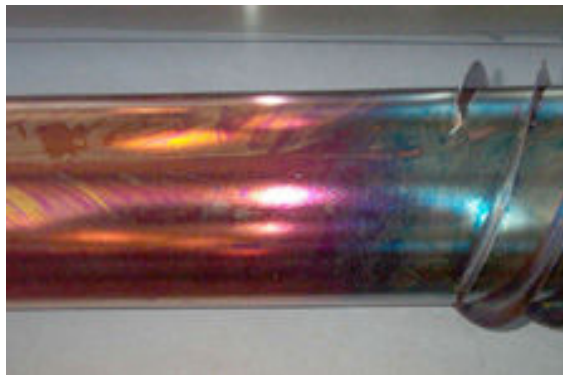
Slika 9. Primjer ružing korozije [16]
