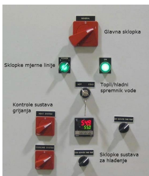
Slika 26. Prikaz prekidača na elektro-ormariću ispitne linije
