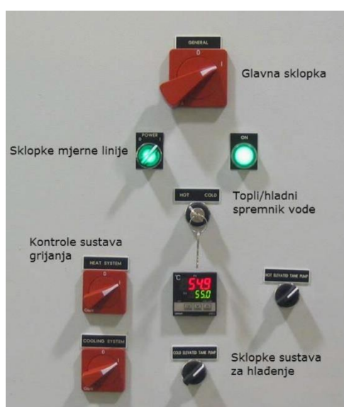
Slika 26. Prikaz prekidača na elektro-ormariću ispitne linije
