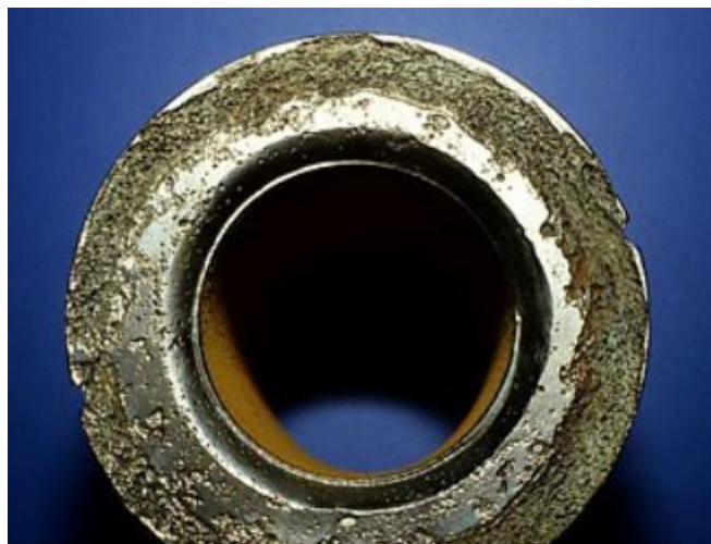
Slika 6. Korozija u procjepu na prirubnici od čelika AISI 316L (EN 1.4404) – cjevovod morske vode [24].
