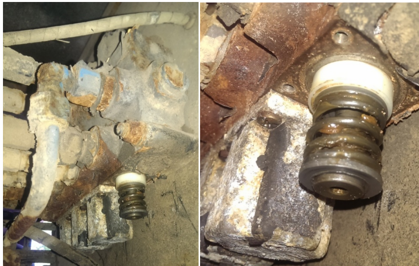
Slika 6.1 Stari razvodnici (bez elektromagneta)
