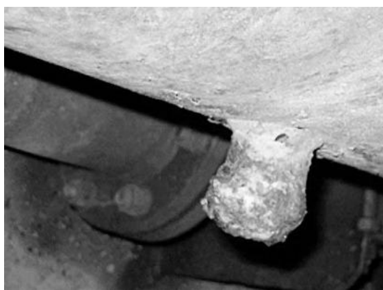
Slika 18. Oštećenje izazvano galvanskom korozijom na cijevi od ugljičnog čelika izravno zavarenoj na cijev od 90/10 Cu – Ni legure [12]
