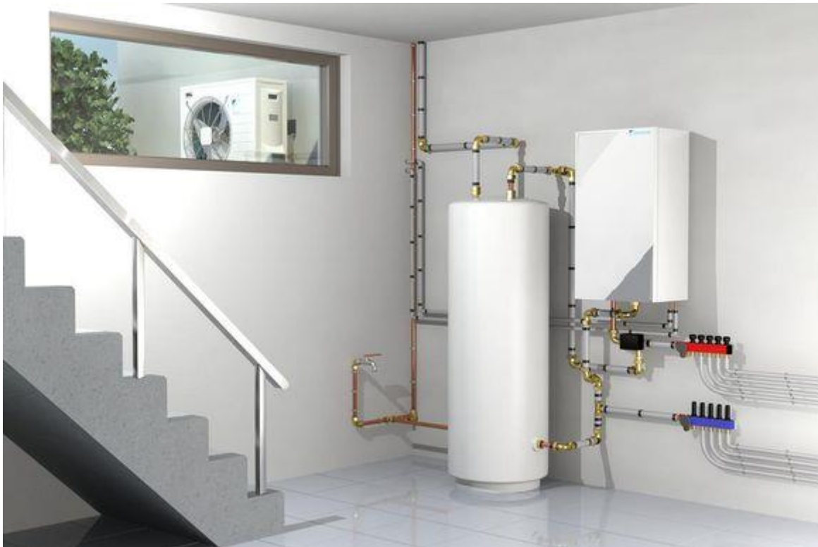
Slika 1.5 Dizalica topline zrak-voda kao primjer sustava posebne izvedbe
