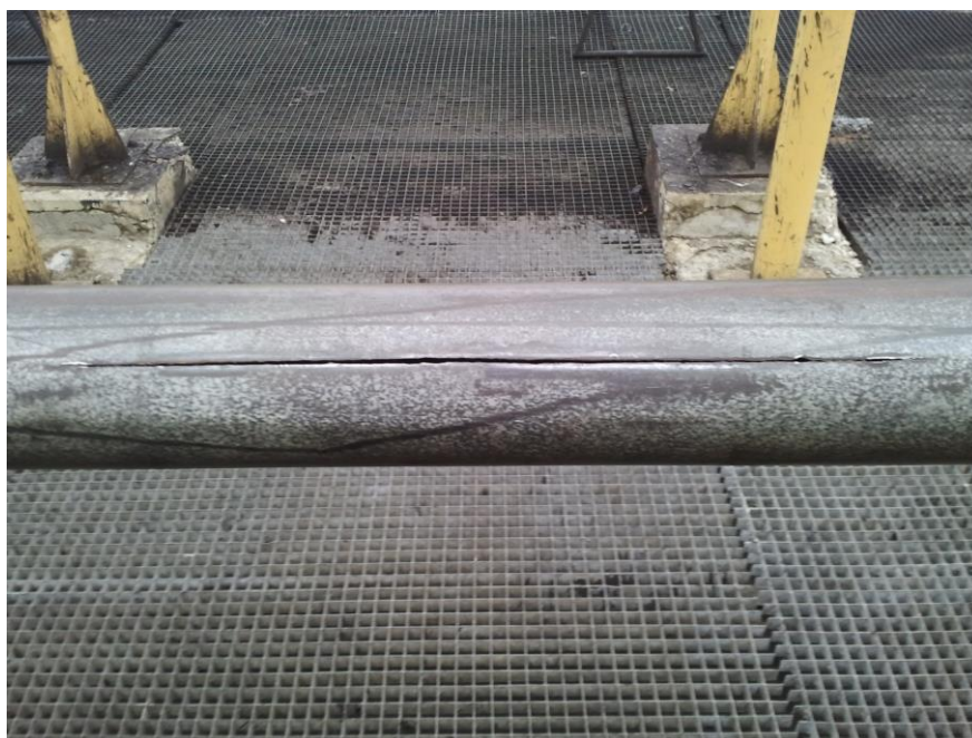
Slika 5. Primjer oštećenja na crpnoj cijevi uzrokovano trenjem šipke, vanjsko puknuće (naftno polje Žutica)
