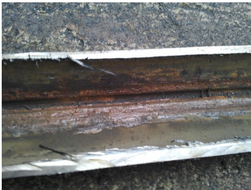
Slika 6. Primjer oštećenja na crpnoj cijevi uzrokovano trenjem šipke, unutarnja oštećenja (naftno polje Žutica)
