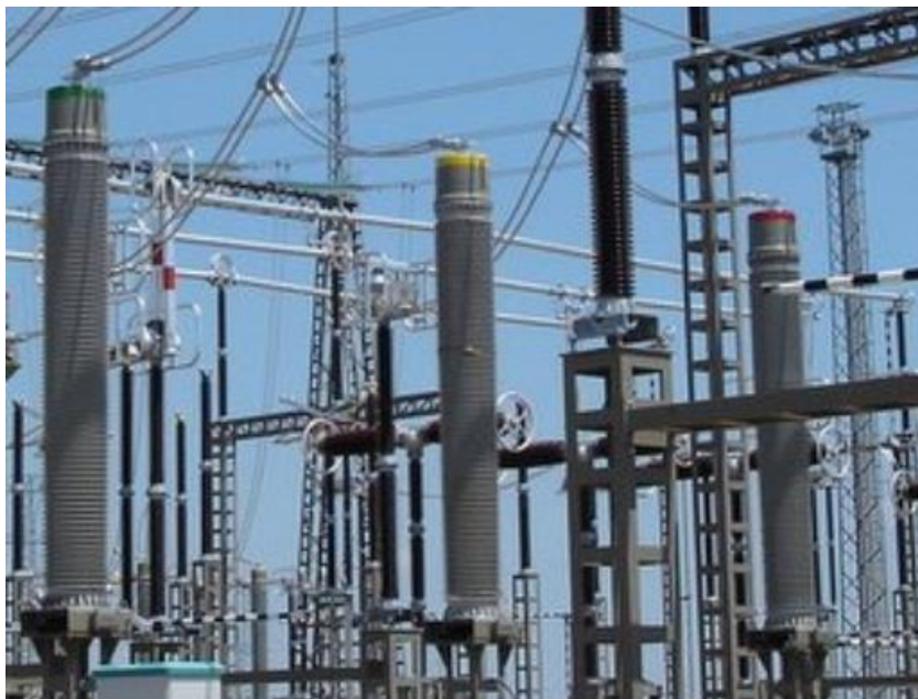
Slika 6. Induktivni naponski mjerni transformator VPU[1]
