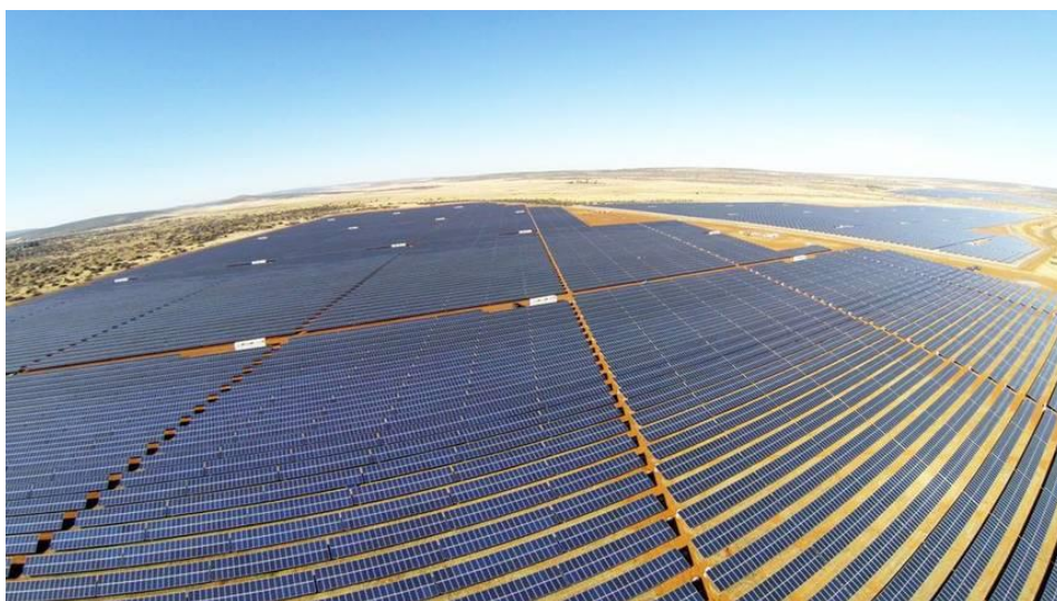
Slika 8. Solarna fotonaponska (PV) elektrana [13]
