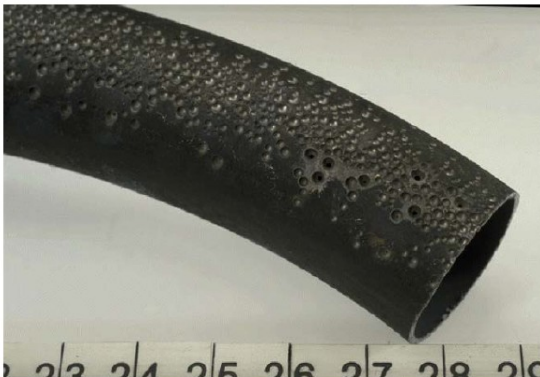
Slika 22. Rupičasta korozija u obliku malih jamica po površini cijevi [24]
