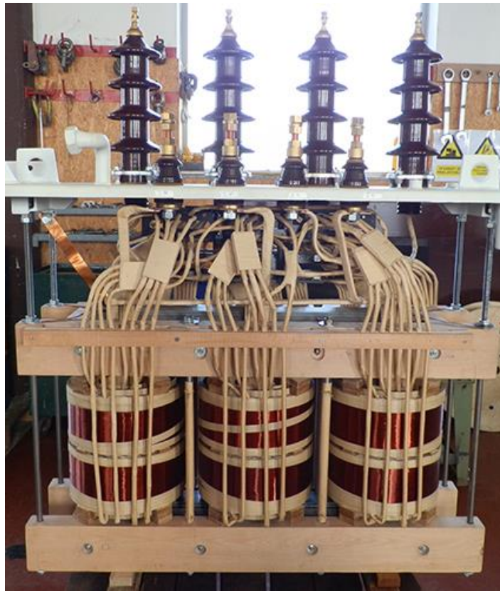
Slika 23. Izolacija trofaznog namota transformatora
