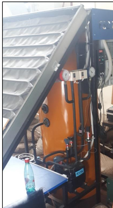
Slika 4. Akumulacijski spremnik Wolf SEM – 300, FSB Zagreb
