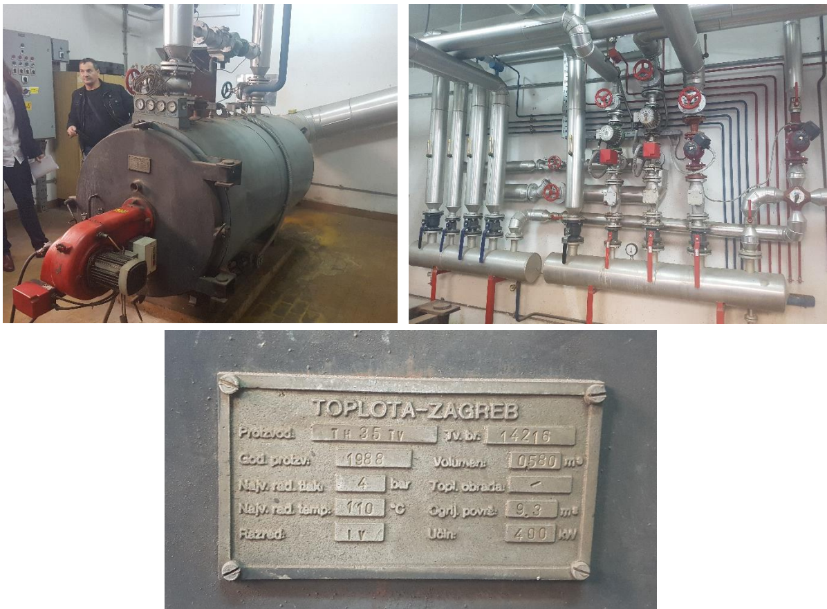
Slika 3.3 Kotlovnica zgrade gradske uprave Grada Kaštela (prosinac, 2018.)
