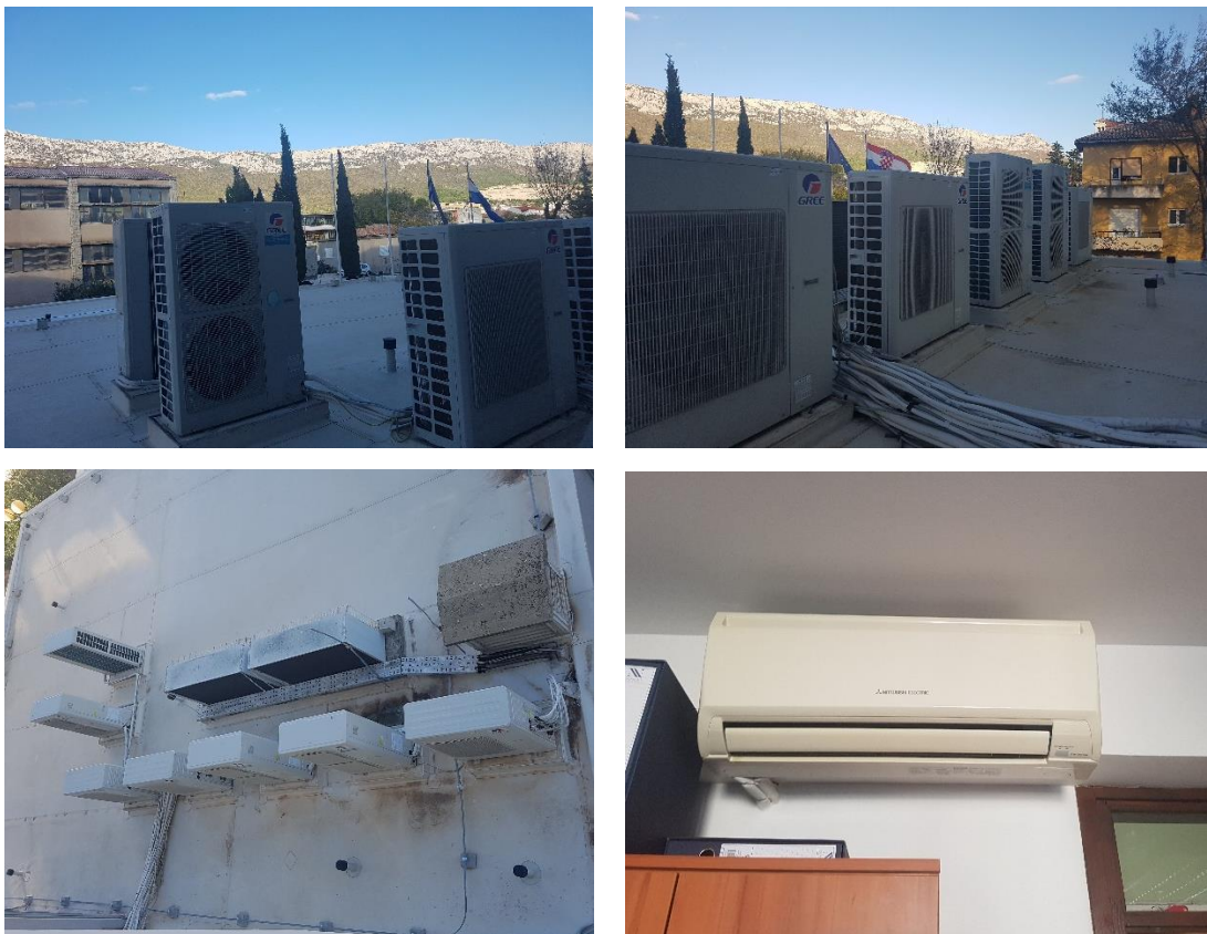
Slika 3.5 VRV sustav zgrade gradske uprave Grada Kaštela (prosinac, 2018.)
