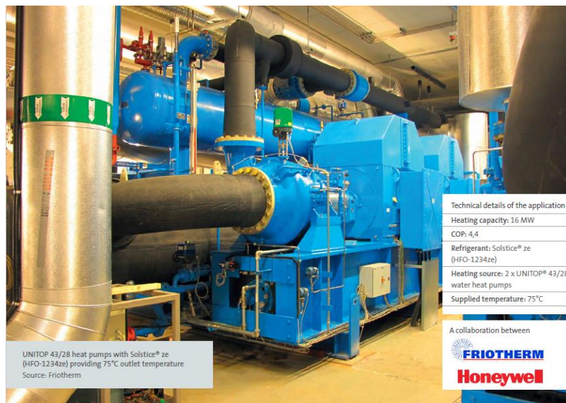
Slika 2.15 Sustav dizalica topline morska voda - voda u Fornebu-u, Norveška [27]
