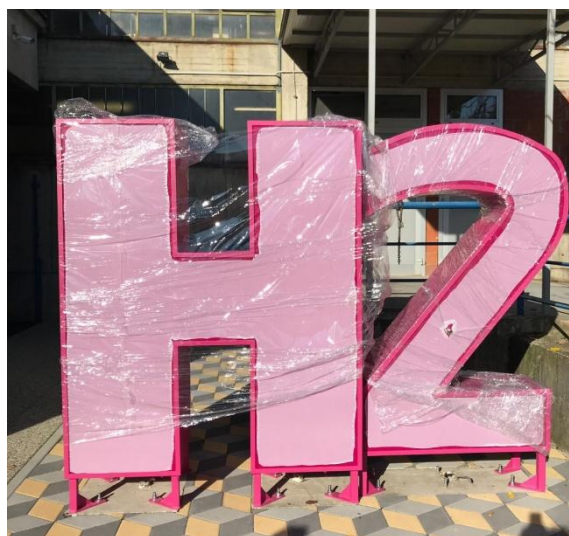
Slika 18. Kućište punionice vodika instalirano na lokaciji
