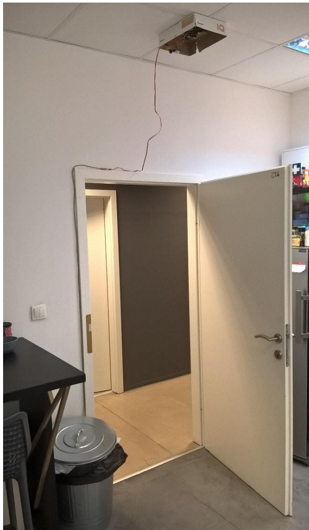
Slika 26. Senzor postavljen na stropu iznad kuhinjskih vrata
