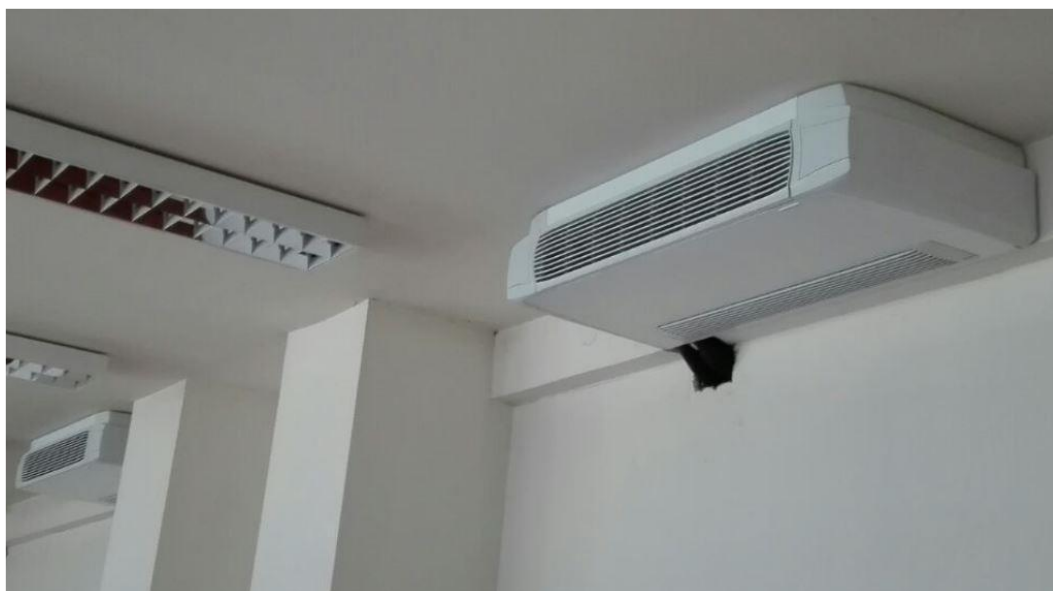
Slika 4. Ventilokonvektor u učionici S5
