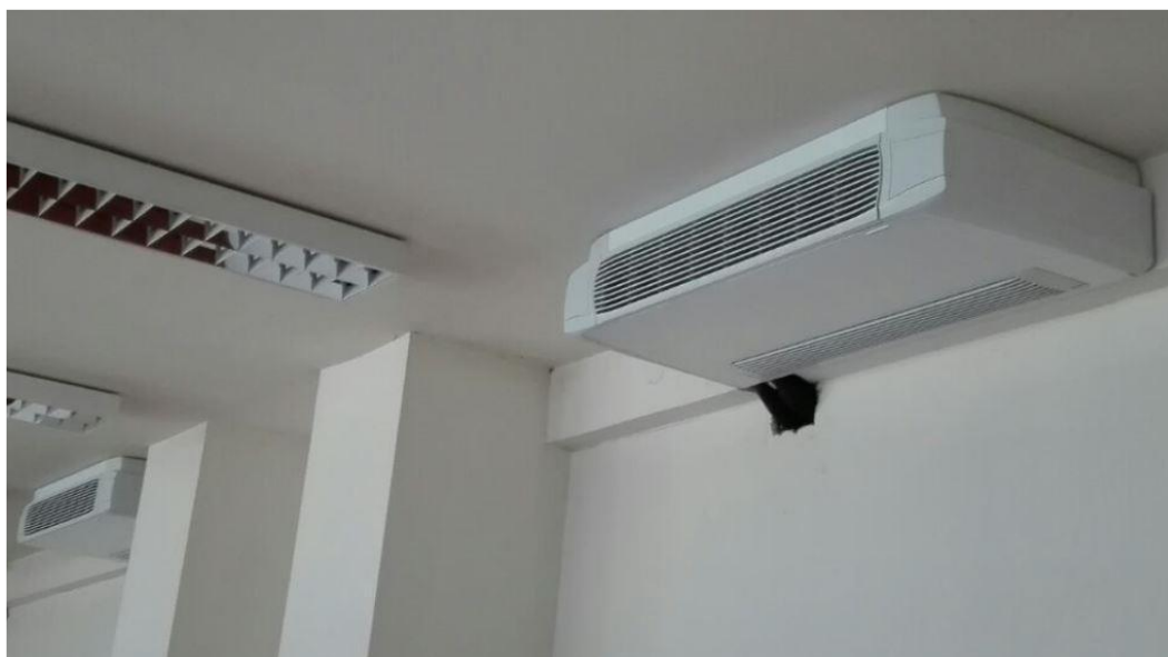
Slika 4. Ventilokonvektor u učionici S5
