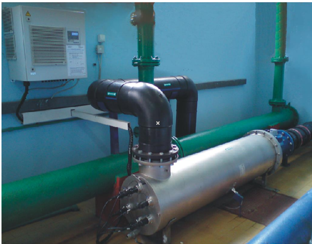
Slika 11. WEDECO UV uređaji, Vodoopskrbni sustav Pakrac – Lipik, Vodozahvat Šumetlica [7]
