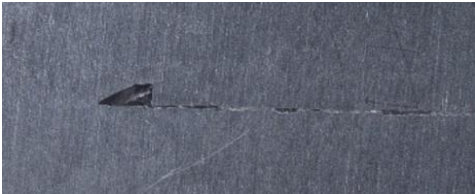
Slika 7.2. Pogreška zavarenog spoja 3
