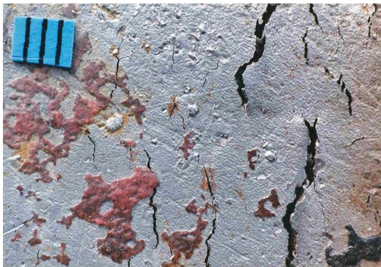
Slika 25. Interkristalna korozija na području zavarenog spoja nehrđajućeg čelika [26]
