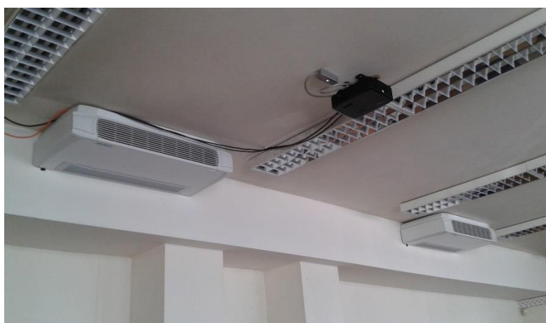
Slika 8, Ventilokonvektori za grijanje učionice
