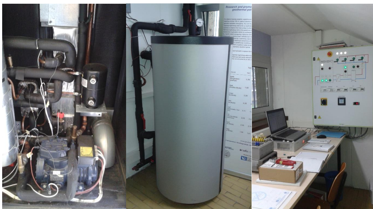
Slika 7, Dizalica topline, spremnik ogrjevne vode, sustav za praćenje parametara
