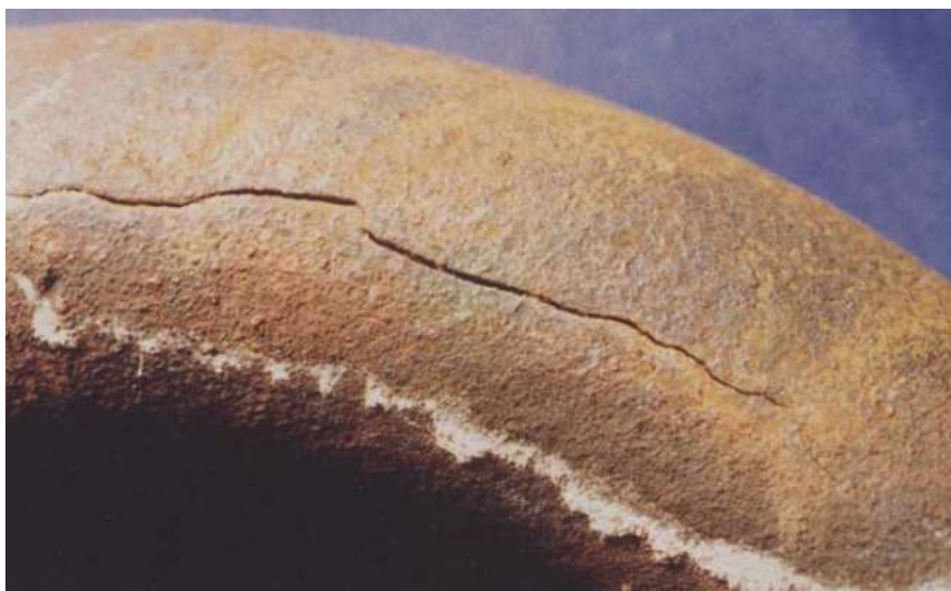
Slika 12. Primjer napetosne korozije na ugljičnom čeliku [11]
