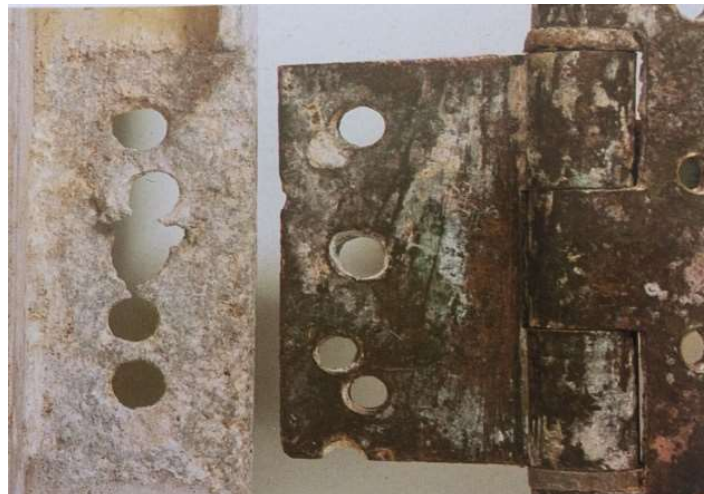
Slika 6. Galvanska korozija nastala zbog kontakta aluminija (lijevo) s broncom (desno) [7]
