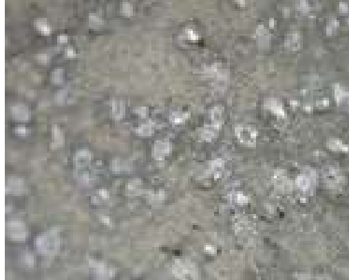
Slika 19. Rupičasta korozija na aluminiju [16]
