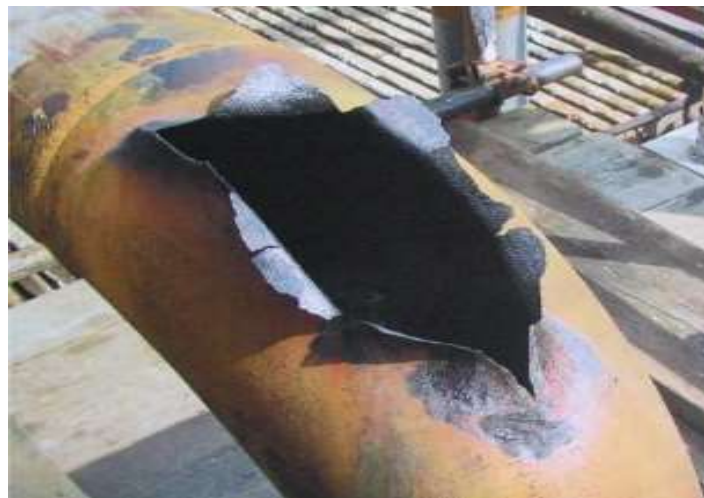
Slika 11. Erozijsko korozijsko oštećenje cijevi za transport nafte [10]
