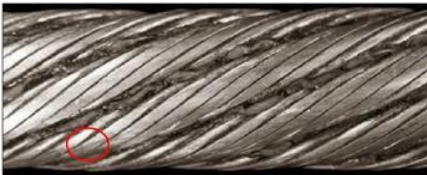
Slika 3. Mehaničko trošenje čeličnih žica bez pojave unutarnjih pukotina [5]
