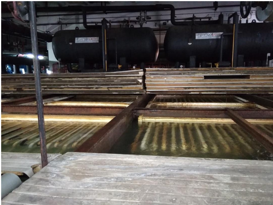
Slika 1. Akumulacijski bazen ledene vode
