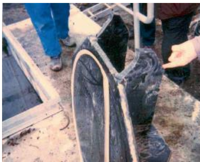
Slika 8. Oštećenje nepovratnog ventila zbog hidrauličkog udara [3]
