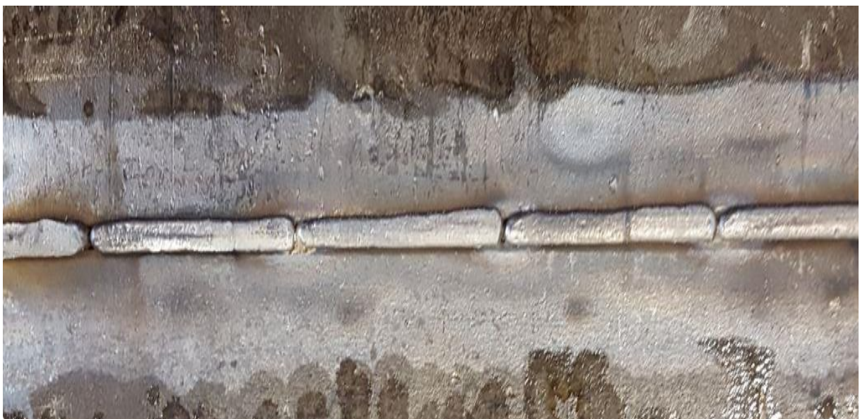
Slika 47. Diskontinuitet korijena zavara
