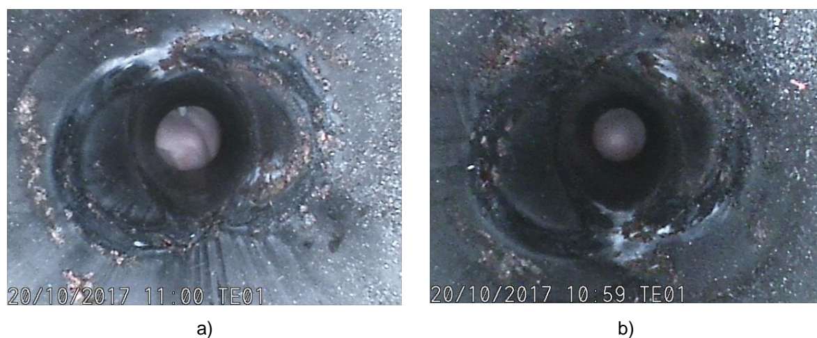
Slika 47. Segment šasije PODNICA: stanje unutrašnje površine cijevi, mjesto zavora
