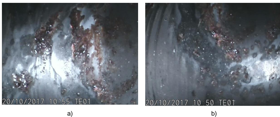
Slika 14. Segment šasije FIREWALL: stanje unutrašnje površine cijevi gdje se vidi osnovni materijal.
