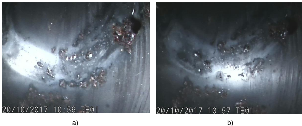
Slika 15. Segment šasije FIREWALL: stanje unutrašnje površine cijevi na mjestu zavara
