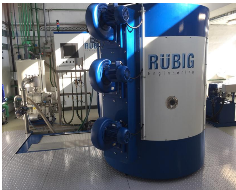
Slika 15 Industrijska peć RUBIG GmbH Type PC 70/90 instalirana na Fakultetu strojarstva i brodogradnje]
