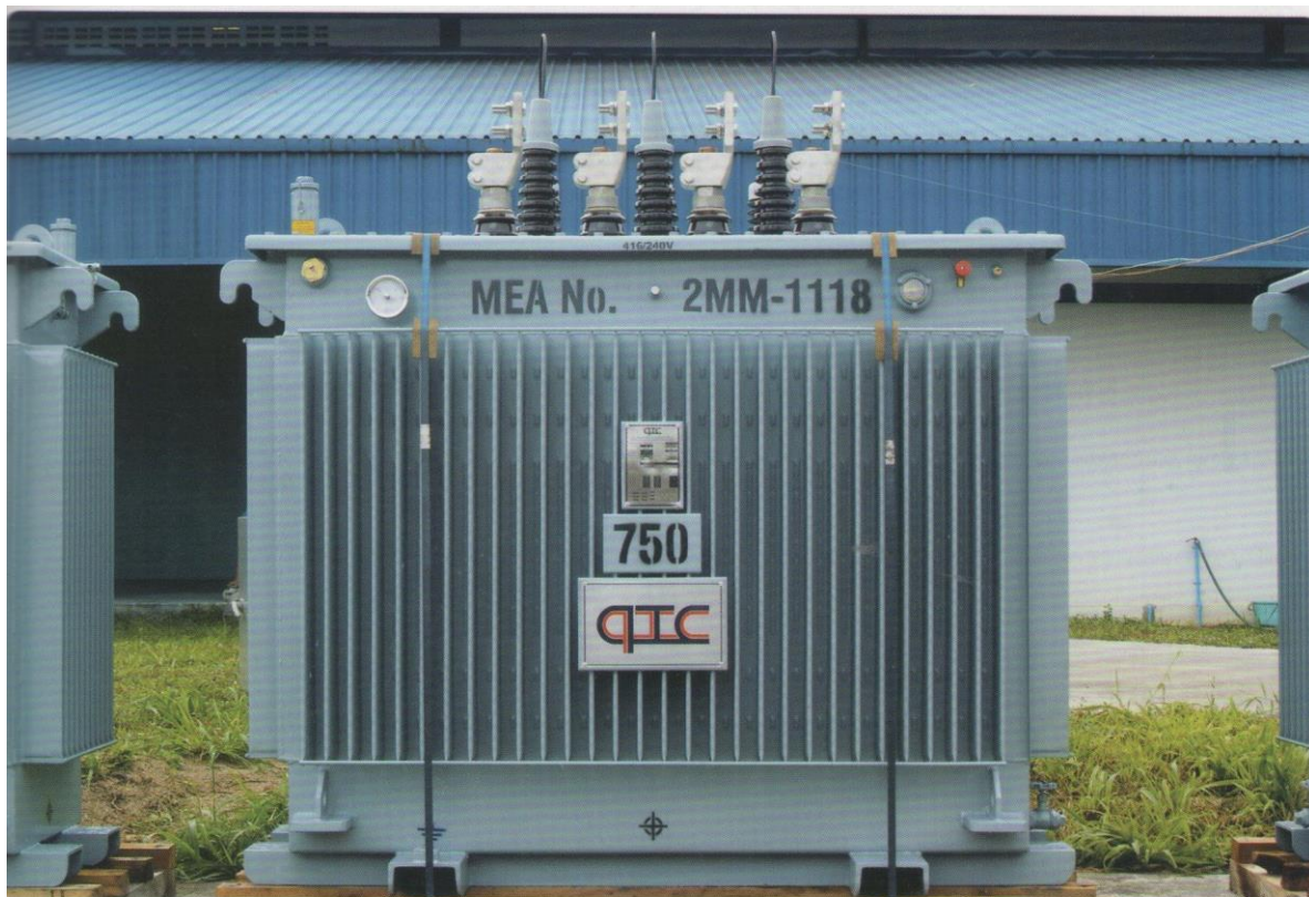
Slika 8. Transformator u eksploataciji [15]
