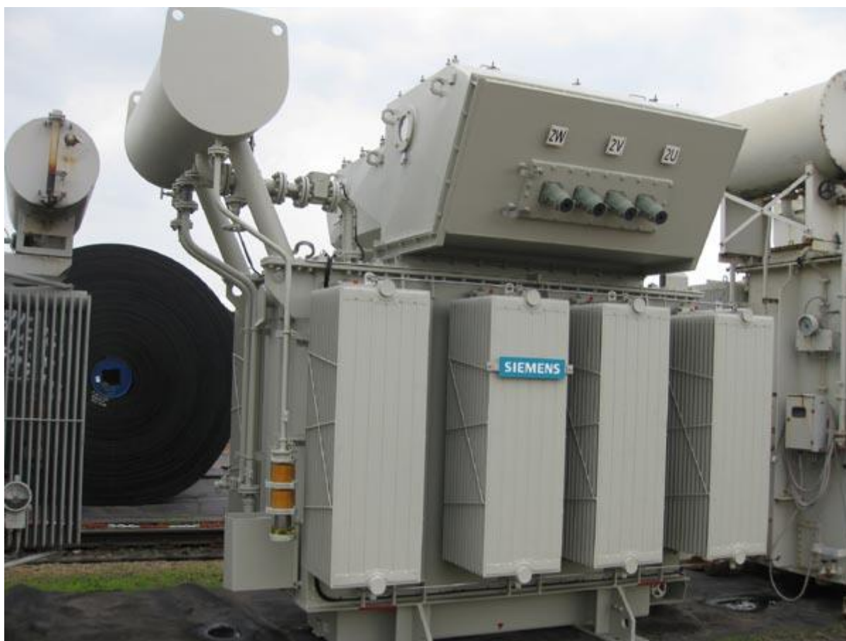
Slika 1. Transformator prije puštanja u pogon
