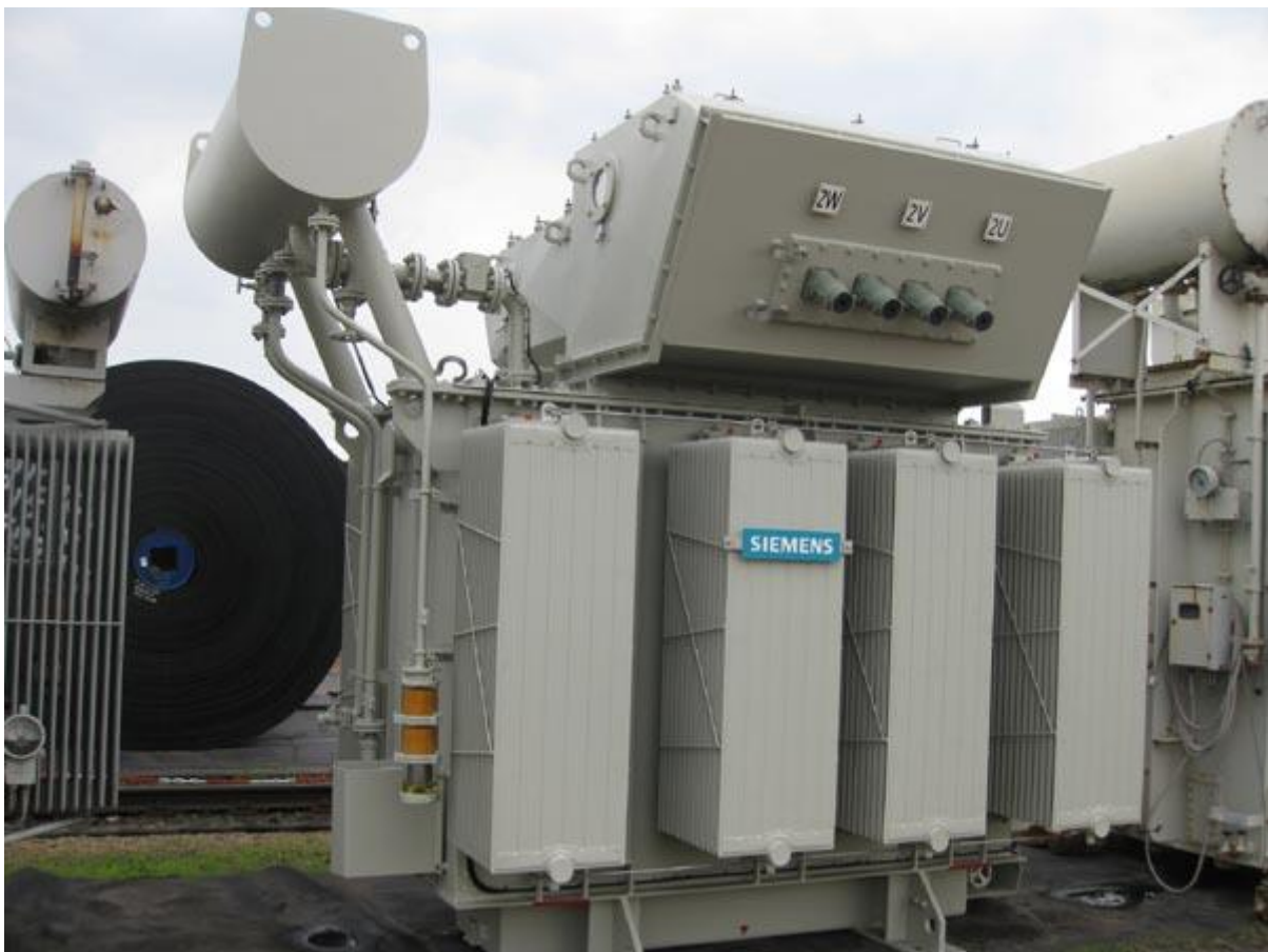
Slika 1. Transformator prije puštanja u pogon
