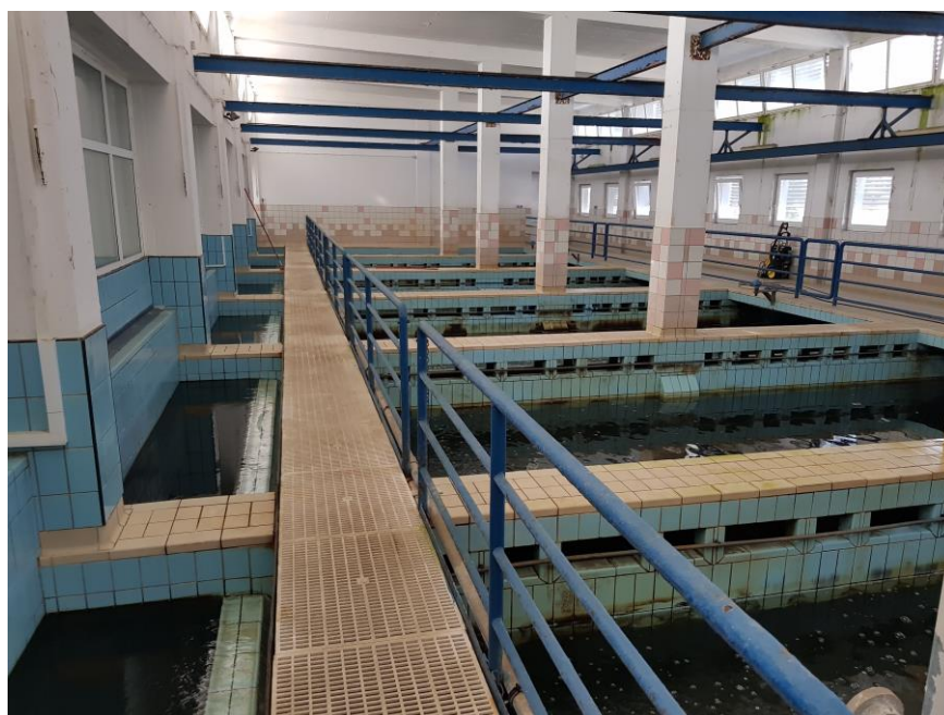
Slika 5.10 Sustav za filtraciju vode
