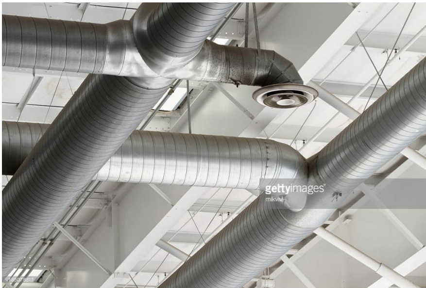
Slika 1.8 Okrugli ventilacijski kanali
