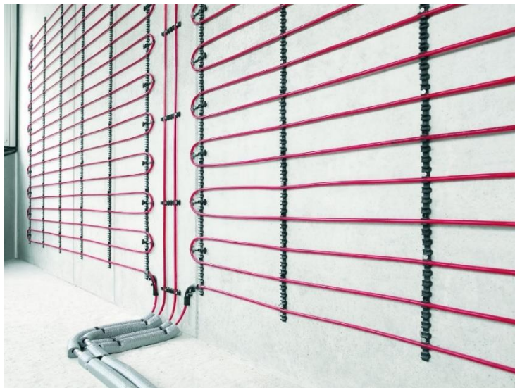
Slika 3.4 Zidno grijanje/hlađenje mokrim sustavom
