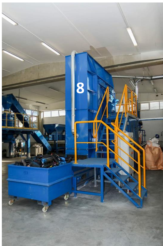
Slika 13. Linija za obradu otpadnih tonera
