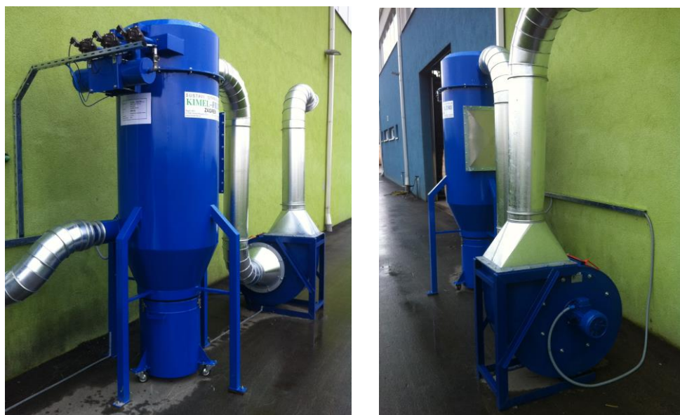
Slika 16. Ciklon i filter s vanjske strane pogonske zgrade
