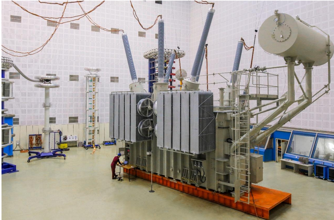
Slika 1. KPT-ov transformator u ispitnoj stanici [3]
