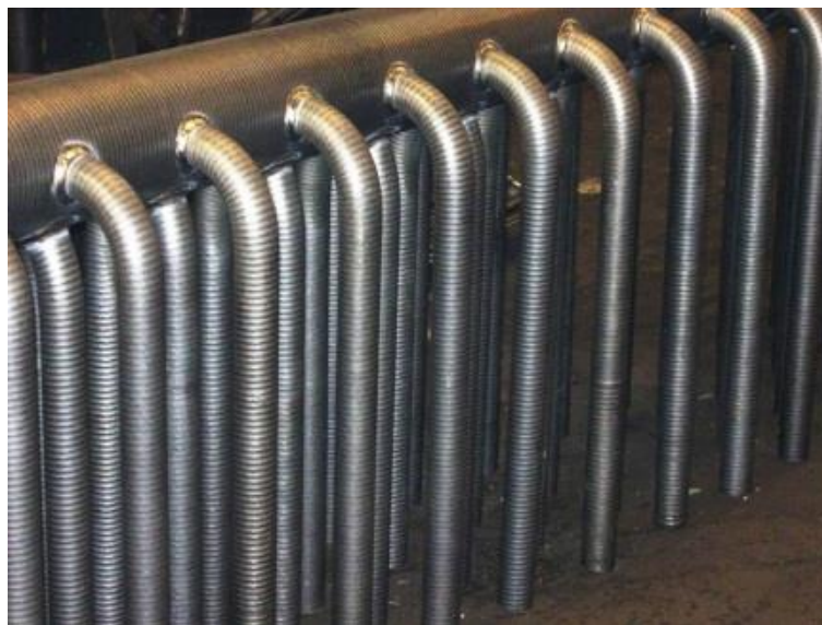
Slika 39. Kotlovske cijevi obložene Inconelom 625 [33]
