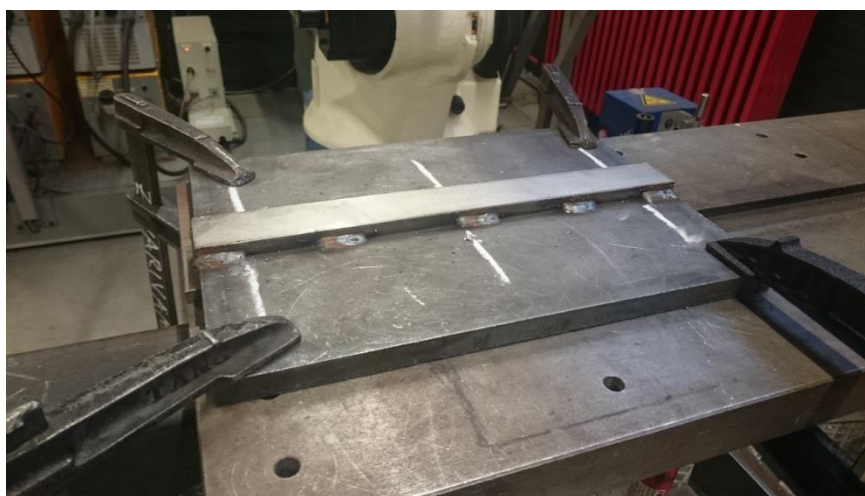
Slika 45. Pričvršćivanje ploče (podloge) prije zavarivanja
