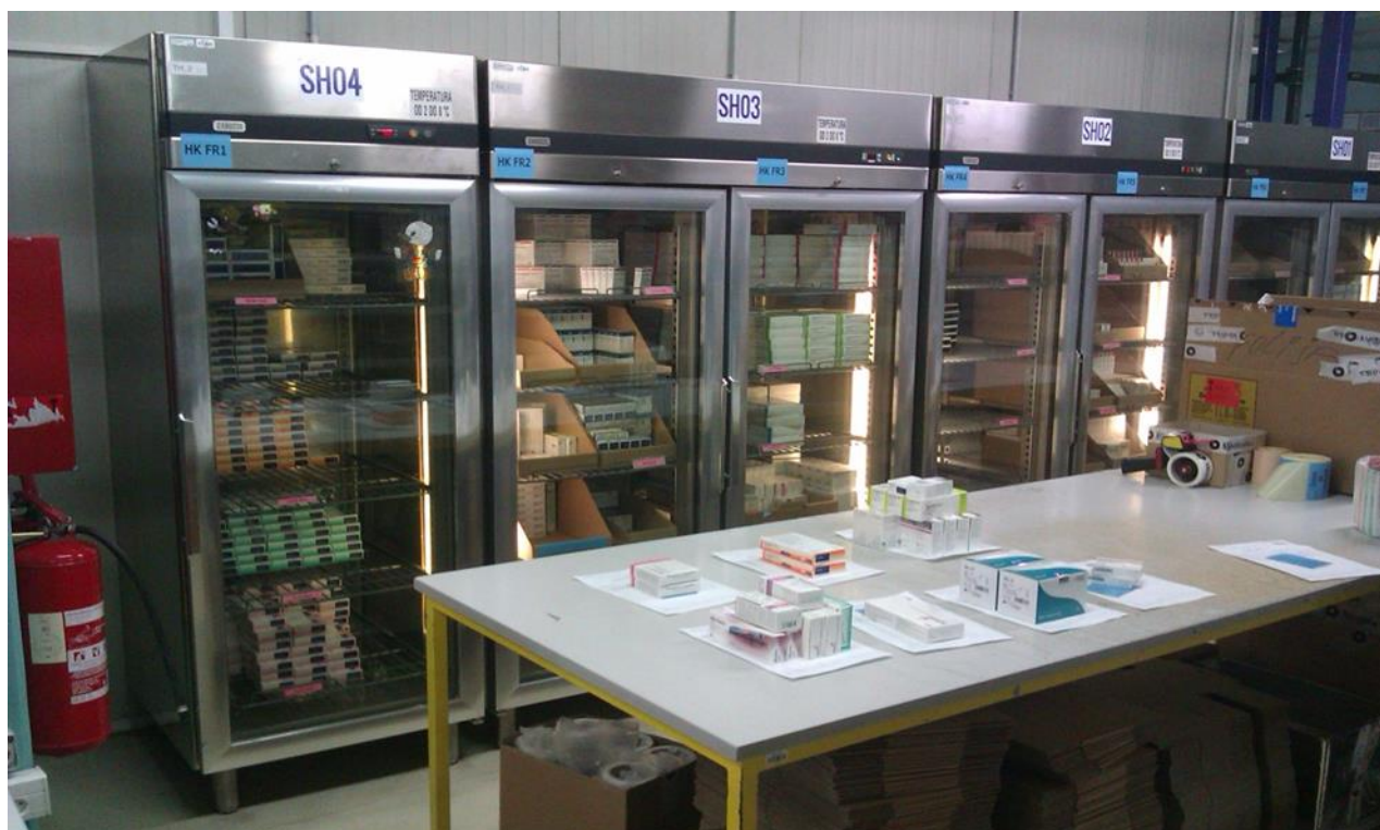
Slika 3.26. Radna stanica hladnog lanca i samostojeći hladnjaci
