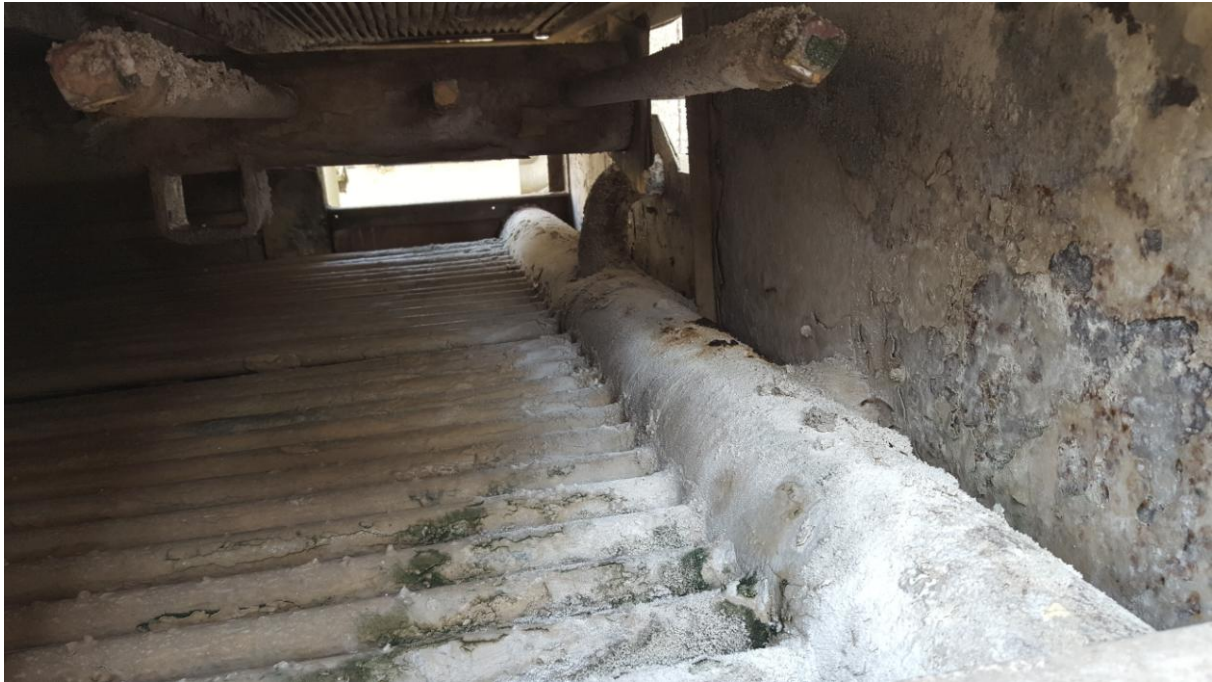
Slika 6. Kamenac u evaporativnom kondenzatoru
