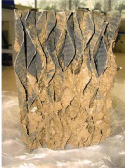
Slika 14. Nečistoće na rashladnoj ispuni (kamenac)
